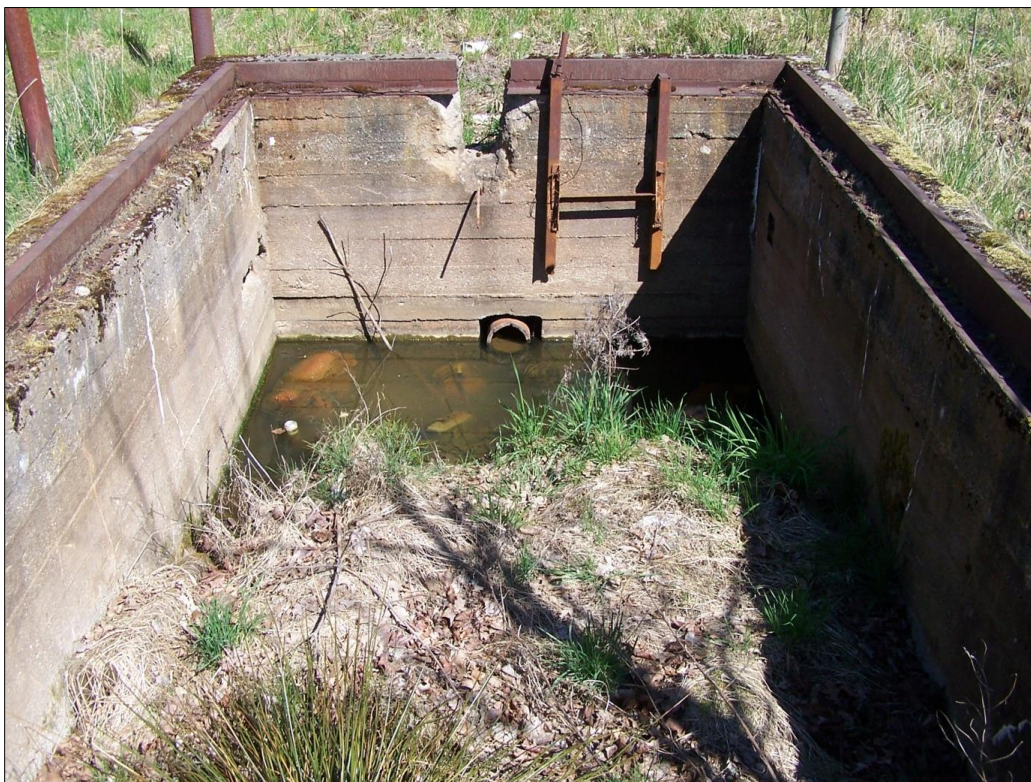
Fot. 23. Pozostałość ziemnej konstrukcji betonowej, stanowiącej pułapkę antropogeniczną dla płazów pod Chmielnem (wsp. geograficzne: 54°19'39.3"N 18°05'32.1"E). Obecne były tam 2 gatunki płazów. Zdjęcie z dn. 23.04.2020 r. (Fot. P. Janowski)
