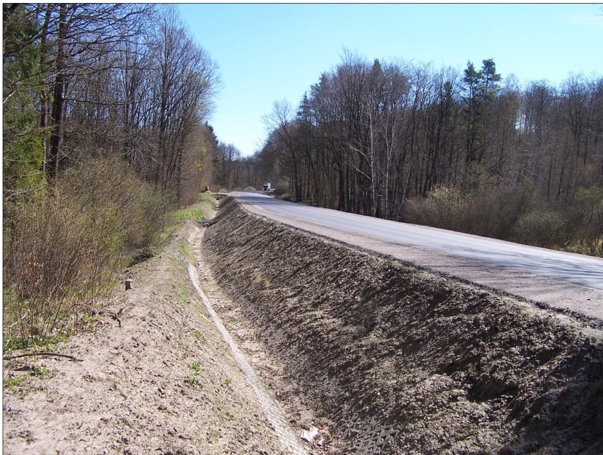
Fot. 31. Nowo zmodernizowana droga wojewódzka nr 211 (DW211) pomiędzy miejscowościami Kartuzy a Łapalice (wsp. geograficzne: 54°20'34.8"N 18°10'18.3"E), nie przewidziano przejść pod drogą dla małych zwierząt ani wygradzeń kierujących płazy do przepustów. Zdjęcie z dn. 23.04.2020 r. (Fot. P. Janowski)
