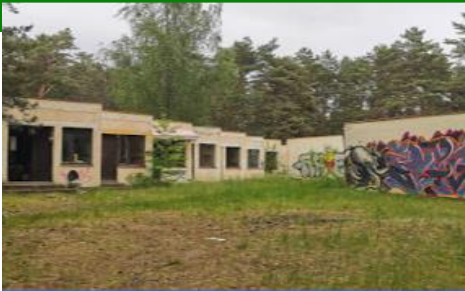
Zdewastowane budynki ośrodka wypoczynkowego w okolicy Wdzydz
